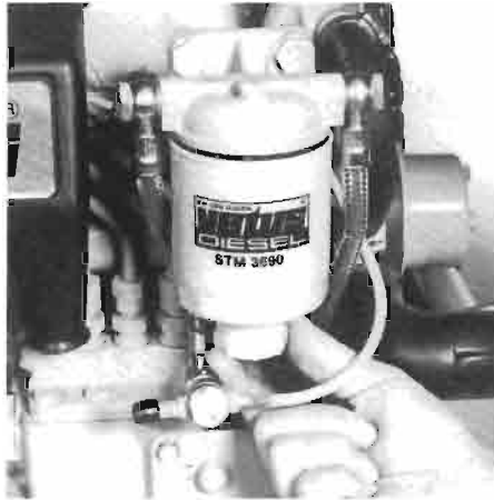
Wasserabscheider entleeren. Purge du séparateur d'eau.
